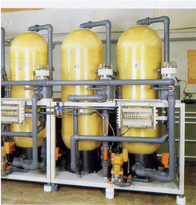
Pendelanlage Frischwasservollentsalzung 15 m 3 /h UVK 65.1 vorgebaute Verfahrensventile, vollautomatisch.
