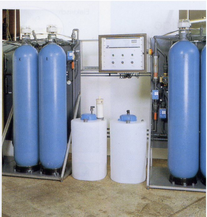
Pendelanlage Kreislauf 2 m 3 /h stark sauer, schwach basisch Top-Montage UVG 20.1 vollautomatisch
